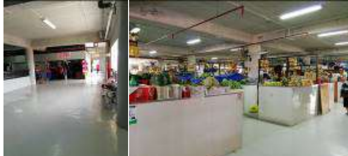
Gambar 4. Tidak ada guiding blok pada lantai di dalam bangunan pasar Sumber: Hasil Observasi, 2019
